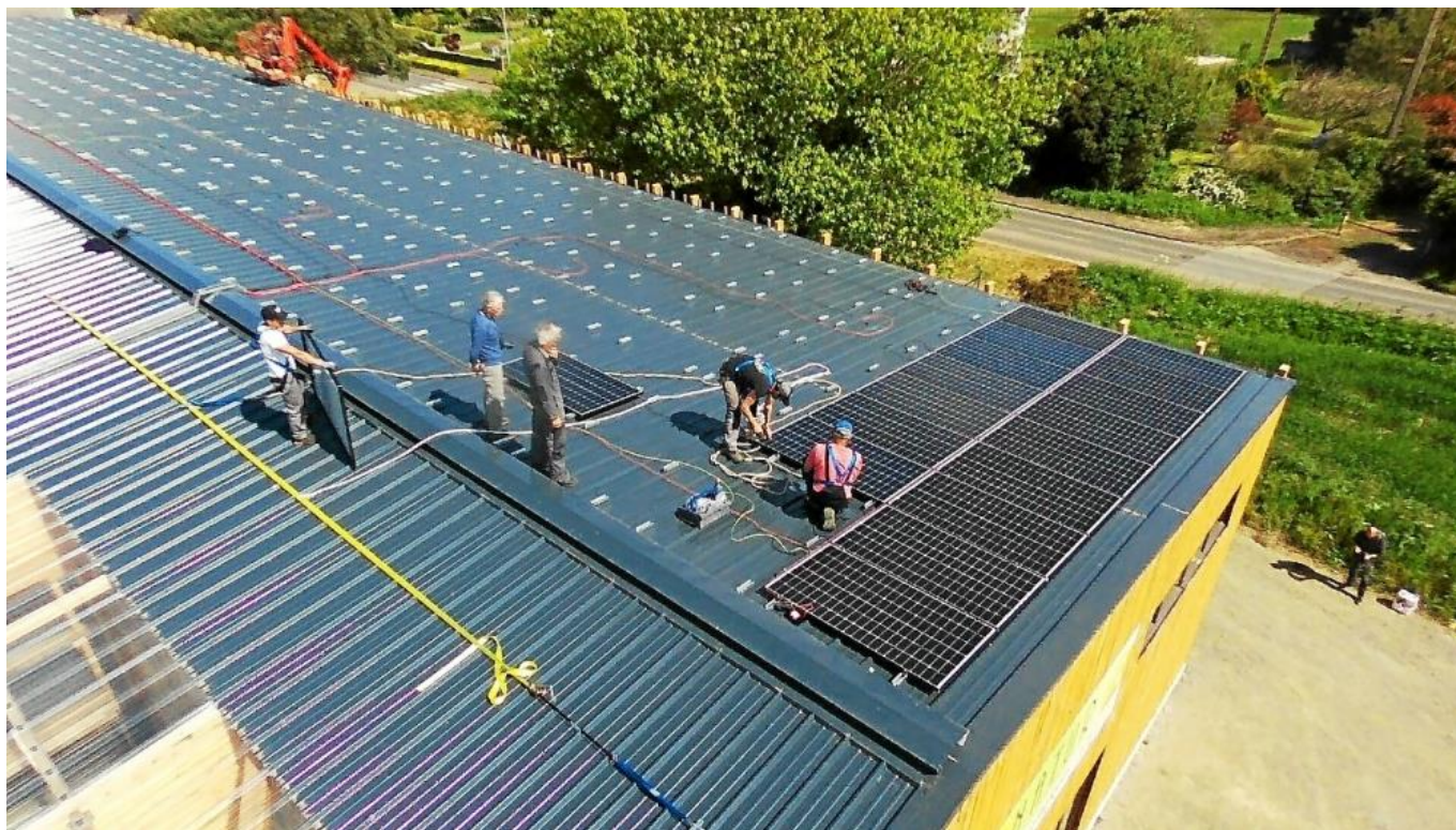
1- Projet Tinature, mise en service à Trémuson sur un bâtiment privé, 92 kWc
