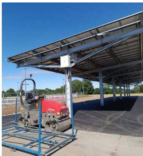
Ombrières photovoltaïques du complexe omnisport
